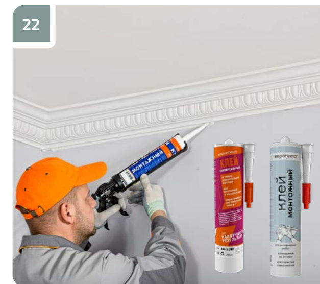
22 Заполнить клеем места примыкания изделия к стене и потолку на тех участках, где клей не выступил.
