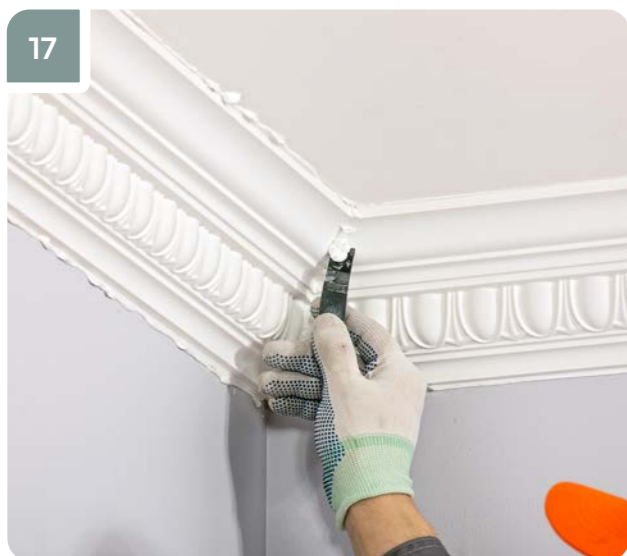
17 Сразу после приклеивания удалить выступившие на стыке излишки клея шпателем. Удалить излишки клея в местах примыкания к стене и потолку согласно шагам 7 и 8.
